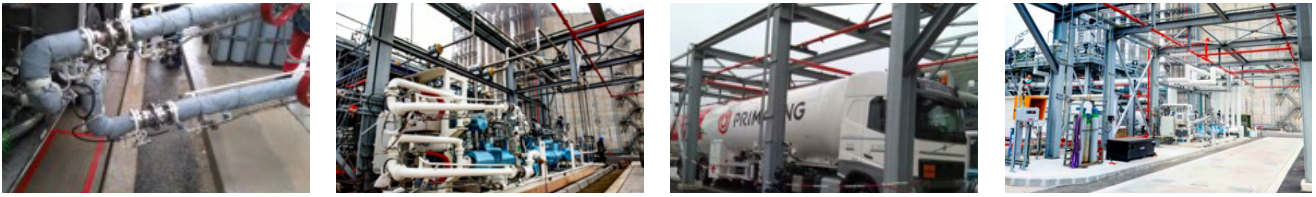
LNG road-tanker filling station at the Dunkirk LNG terminal
